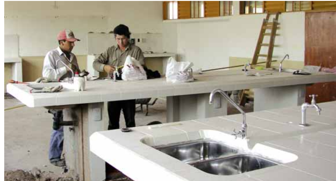
El laboratorio permitirá profundizar los requerimientos del plan educativo para mejorar la capacitación de los alumnos y así optimizar su salida laboral.
